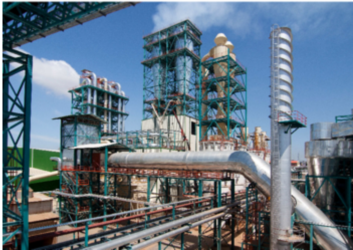
Planta de Energía
